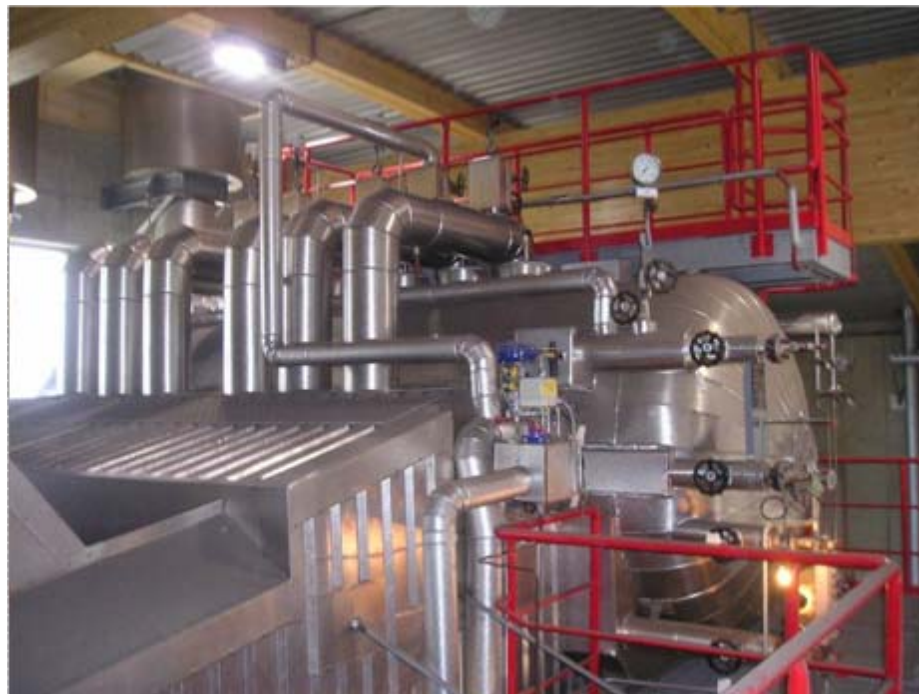
Dampferzeuger im isolierten Zustand
