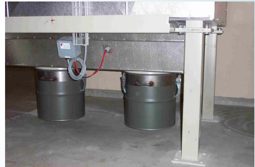
Bunkerbeheizung am Mini-Elektrofilter
